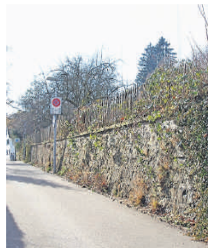
Diese ehemals denkmalgeschützte Mauer muss wohl einer Tiefgarageneinfahrt weichen. Foto: zvg.
